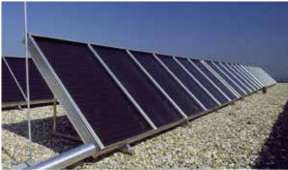
Illustration 7 : Solaire thermique sur un toit plat
